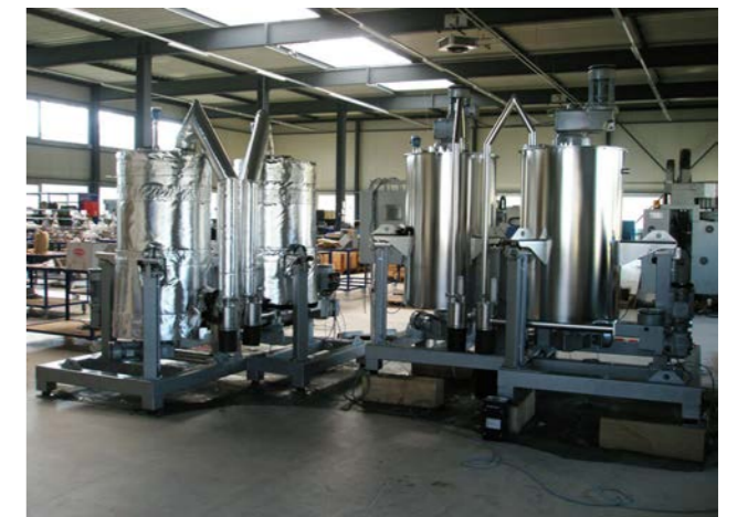
Batterieproduktion Dosiergeräte komplett isoliert
