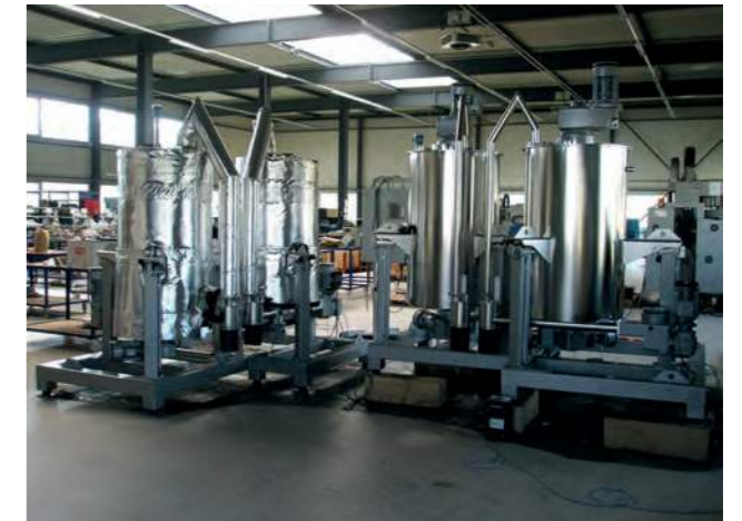
Batterieproduktion Dosiergeräte komplett isoliert
